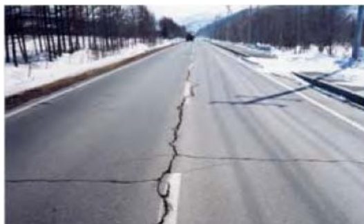
凍上による舗装のひび割れ
